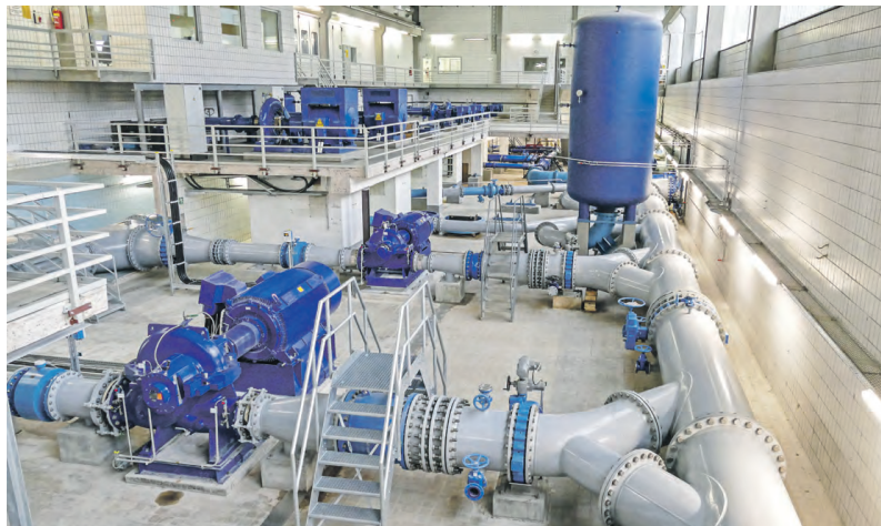
Vertikales Asset: Jede Anlage wird dokumentiert und mit einer Vielzahl an Kenndaten versehen. Im Bild ist eine Druckerhöhungsanlage zu sehen. Bild: Hessenwasser
