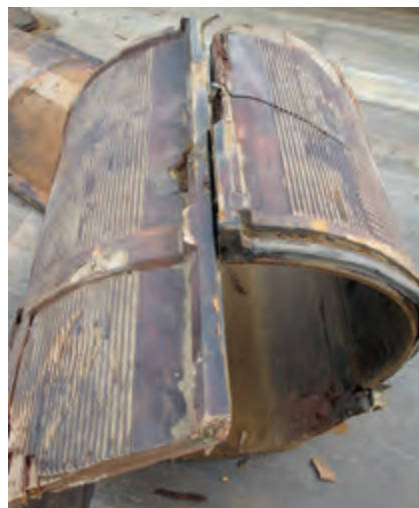
An den Brunnenanlagen aus den 1960er-Jahren sind die Jahrzehnte nicht spurlos vorübergegangen.
